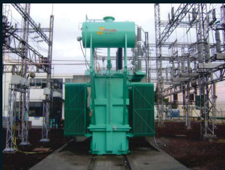
TRANSFORMADOR DE 18/24 MVA, 115/13.2 KV, PLANTA KIRIU, TOLUCA
